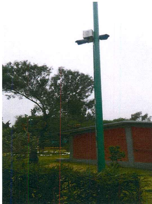
CÁMARA UBICADA EN EL PASILLO DEL ESTACIONAMIENTO DE GOBIERNO
