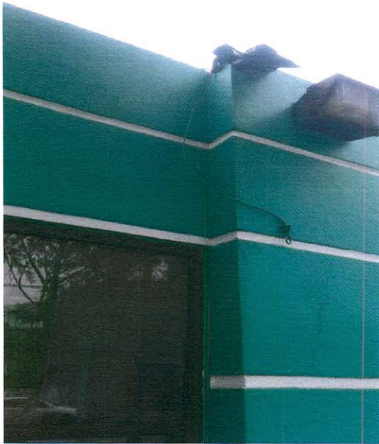
Cámara ubicada en la caseta de Gobierno, del lado Derecho.
